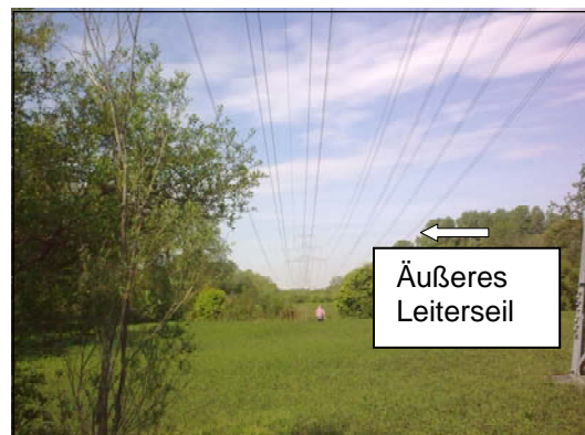
Abbildung 25: Hochspannungsfreileitung nördlich Fischerhäuser
